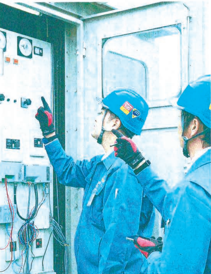
電気設備を点検する北陸電気保安協会の社員 ＝石川県白山市
